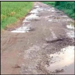
टूटी पड़ी सड़क
